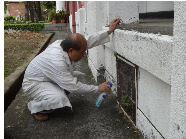
古蹟風洞及水溝處理
