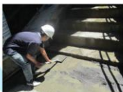
工區內積水派員將用砂覆蓋避免積水處理。
