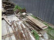
工務所旁物料堆置區應整理、移除廢料，以避免蚊蟲孳生。
